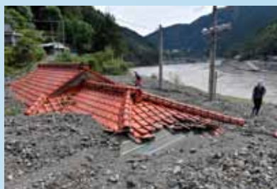
土砂に埋もれた八代市坂本町三坂公民館
