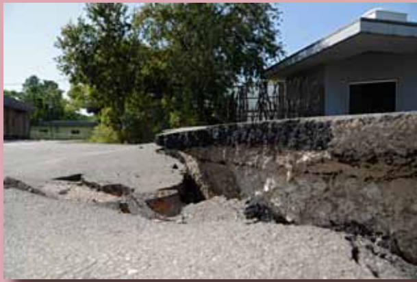
地震から20日後、園内の道は約30センチ陥没したままだった
